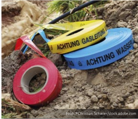
Bild 37: Trassenwarnbänder für Gas- oder Wasserleitungen sowie Niederspannungskabel
