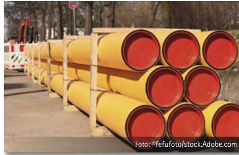
Bild 11: Rohre mit Verschlusskappe
